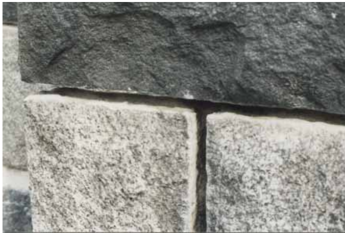
Yllä julkisivukivien saumoja avattuna ja puhdistettuna uudelleen saumausta varten. Oikealla valmiiksi saumattua julkisivua.
